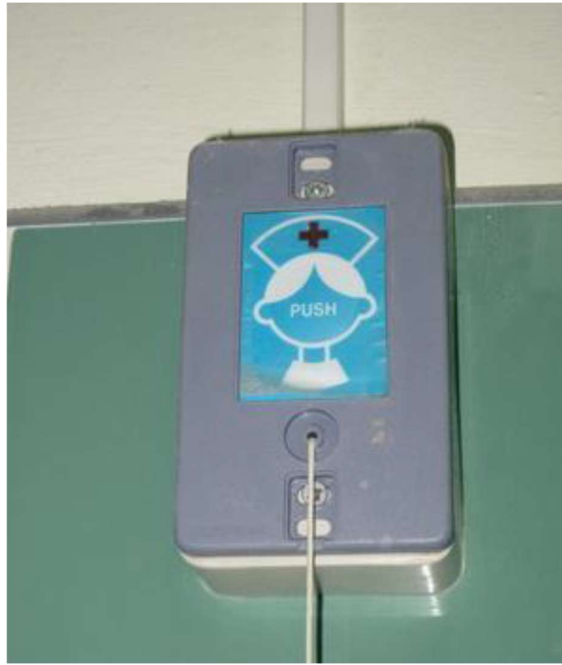
ภาพที่ 4.5.4 สวิตช์ดึงฉุกเฉินในห้องน้ำ (Switch for Bath room)
